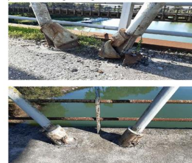
STRALLI - Distacco del getto di boiacca a protezione degli stralli; - Danni su camicia protettiva ed elementi della base degli stralli. Gli stralli presentano diverse criticità nello stato di conservazione in quanto gli elementi metallici strutturali risultano esposti agli agenti atmosferici, a causa dei danni esistenti sui diversi elementi di protezione e del degrado del getto di boiacca.
