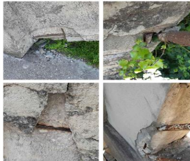
BASE ARCATI IN CLS - Lesioni e/o distacchi di spigoli e deterioramento copriferro; - Lesioni copriferro nelle zone di connessione tra struttura in cls e parapetto metallico. Tali lesioni sono rilevabili su tutta la struttura in cls, in alcune zone si rileva uno stato di degrado consistente, con distacco completo di porzioni di copriferro ed esposizione delle armature metalliche.
