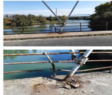
STRALLI LESIONATI IN SEGUITO ALL'INCIDENTE DEL 2019 - Lesione completa del 4° strallo (lato Regione Campania); - Danni sulle camicie protettive e sul getto di boiacca del 3° strallo (lato Regione Campania). In seguito all'incidente stradale del 2019, il 4° strallo non è più in sede e risulta totalmente lesionato, presentando una sezione netta di rottura degli elementi strutturali in acciaio.
