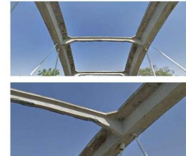
ARCATA E TRAVI TRASVERSALI IN CLS - Lesioni e/o distacchi di spigoli e deterioramento copriferro; - Macchie di umidità. Tali lesioni sono rilevabili lungo tutta la struttura in calcestruzzo, in particolar modo nella zona degli spigoli delle travi trasversali, che risulta maggiormente esposta agli agenti atmosferici.
