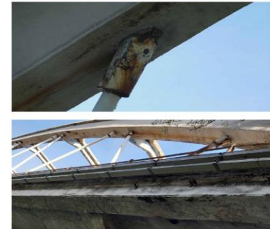
ARCATA IN CLS E PORZIONE SUPERIORE DEGLI STRALLI - Lesioni e/o distacchi di spigoli e deterioramento copriferro; - Macchie di umidità e tracce di scolo. Tali lesioni sono riscontrabili su tutta la struttura in calcestruzzo. Le macchie sono rilevabili lungo l'arcata in cls, in corrispondenza degli agganci della parte superiore degli stralli con tracce evidenti di scolo di materiale metallico ossidato.
