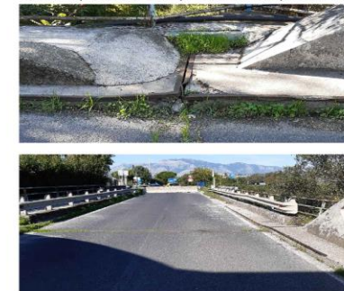
GIUNTO DI DILATAZIONE - Danni in corrispondenza degli elementi di protezione dei giunti; - Presenza di vegetazione e degrado della pavimentazione stradale. I giunti di dilatazione presentano uno stato di conservazione non ottimale con elementi danneggiati e degrado della pavimentazione stradale con crescita di vegetazione all'interno delle fessurazioni ed evidenza di percolamento di acqua sulla testa delle pile sottostanti.
