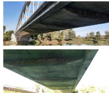
INTRADOSSO SOLETTA IMPALCATO E TRASVERSI - Macchie di umidità; - Lesioni e/o distacchi di spigoli e deterioramento copriferro. Le macchie di umidità, rilevate in diverse zone dell'intradosso della soletta, derivano da infiltrazioni provenienti dalla parte superiore dell'impalcato stesso. I distacchi del copriferro si rilevano su spigoli di travi e traversi.
