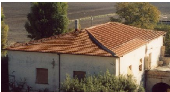
Deformazioni di una copertura in legno.
